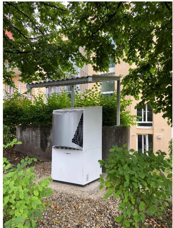
Luft-Wasser-Wärmepumpe im Innenhof der Franz-Seiff-Straße 2
